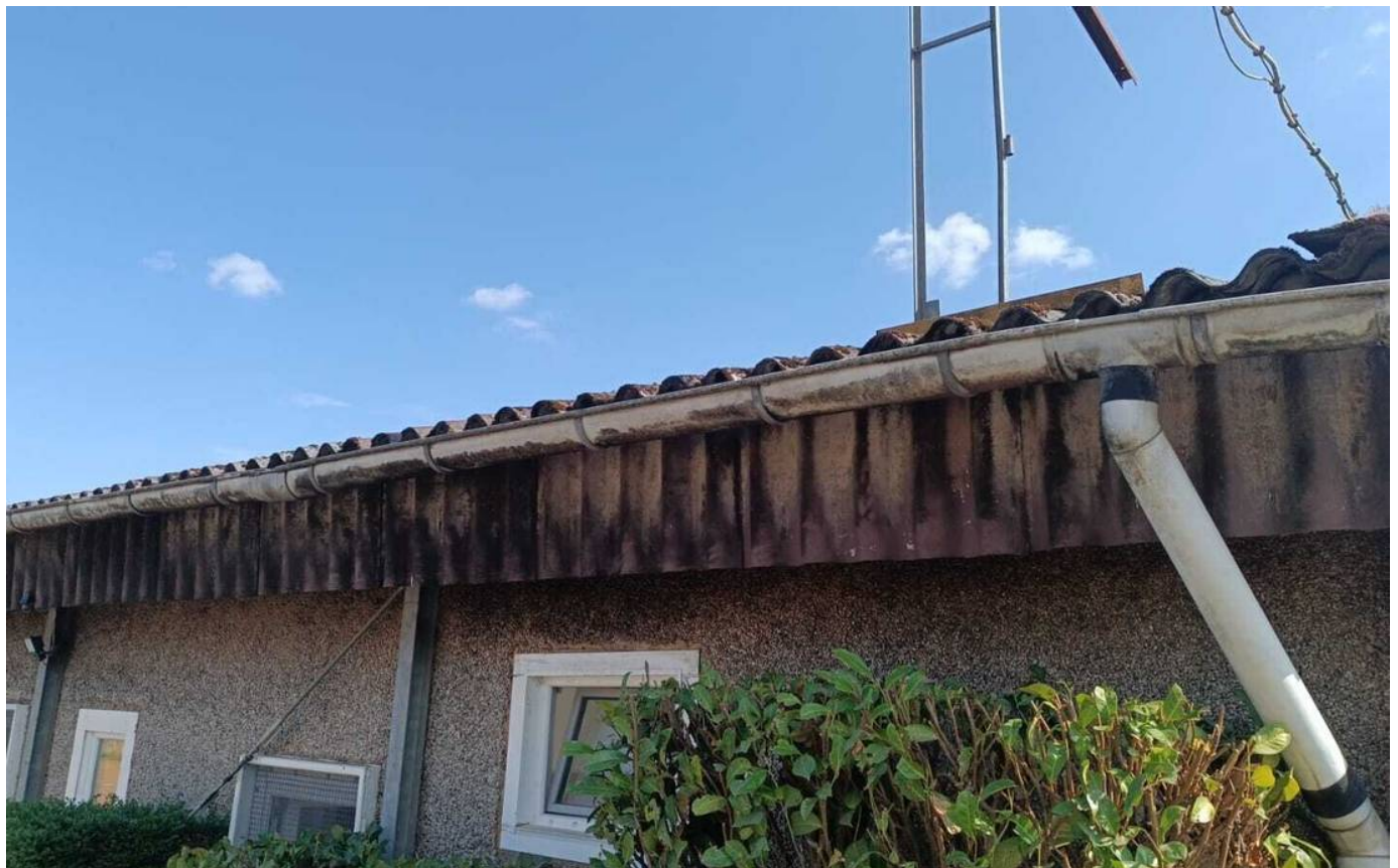
Das Dach des Eifeltierheims ist marode, beklagt der Förderverein.
